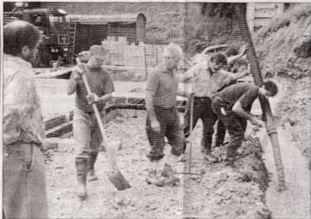
Eigenleistung ist gefragt beim Bau der Festhalle Eicherscheid: Da lassen sich die Bürger nicht zweimal bitten.
